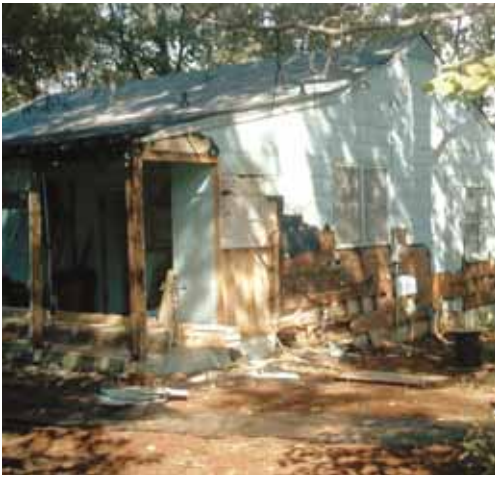
Fig. 17. Tablas de un porche y pared exterior de una casa removidas para señalar el extenso daño causado por termitas.
